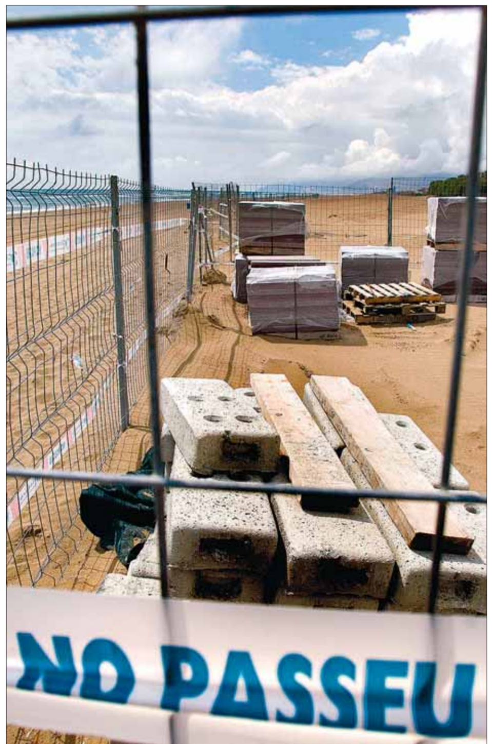
L'obra del passeig Marítim de Gavà s'ha aturat i ha quedat el material a la sorra ■ MANOLO GARCIA
